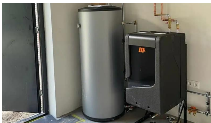
Figuur 16: PVT-warmtepomp in de woning, overgenomen van (Triple Solar, z.d.)
